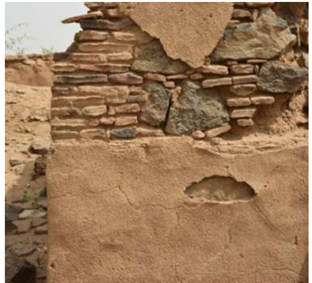
شكل رقم (2) توضح التشرخات الدقيقة في طبقات الملاط الناتجة عن عملية التمدد والانكماش بفعل التغير المستمر في درجات الحرارة.
