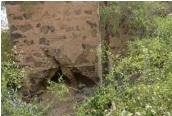
شكل رقم (20) توضح تآكل أساسات أحد البيوت .
