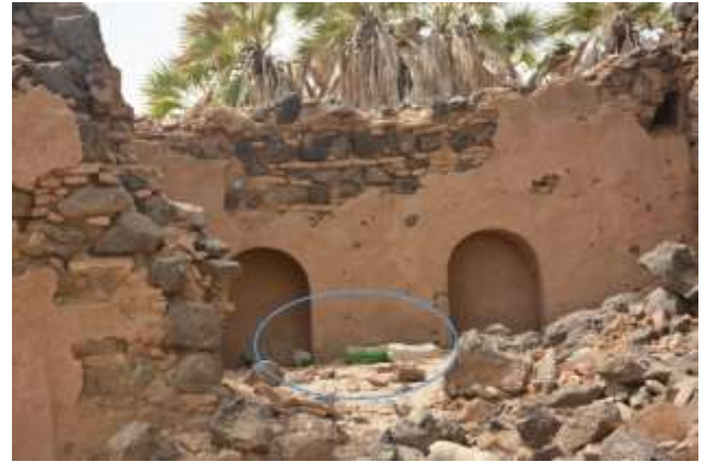
شكل رقم (5) توضح ارتفاع المياه تحت سطحية بفعل الخاصية الشعرية لأحد جدران.
