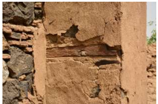
صورة رقم (3) توضح تشرخ وانفصال طبقة الملاط من على احد الواجهات نتيجة لتمدد العوارض الخشبية بداخل الجدار وضغطها على طبقة الملاط الخارجية بفعل الحرارة وفقدانها لمحتواها المائي
