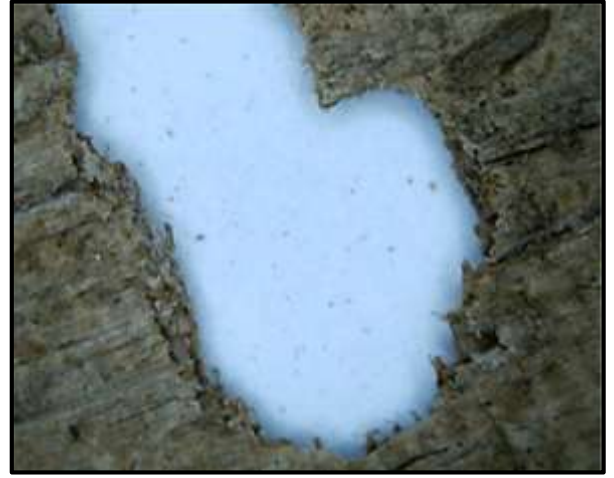
شكل رقم (10) يوضح وجود ثقوب نتيجة تاكل بفعل تلف بيولوجي
