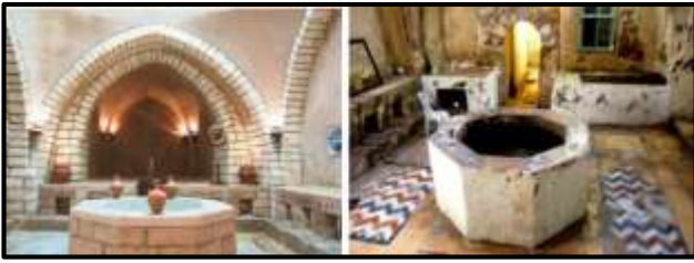
شكل رقم (٥-٦) تحلل وتآكل الأرضيات والحوائط قبل عملية إعادة التأهيل ، استعمال درجات لونية متقاربة في الحمام بعد إعادة التأهيل.
